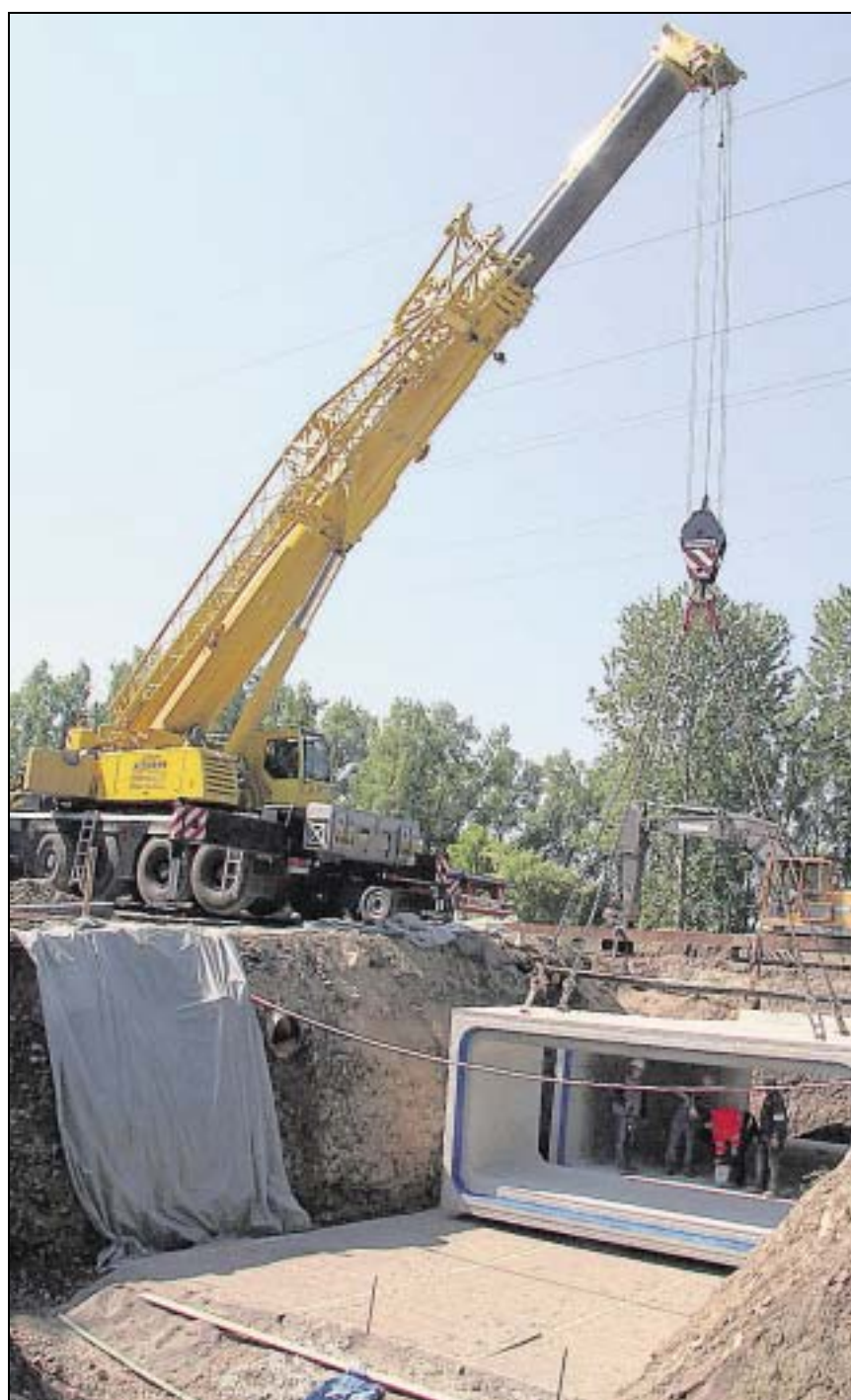
Acht solcher Betonkästen wurden gestern in den Lennehochwasserdamm eingelassen. Der senkrecht zum Damm verlaufende Wannebach soll hier den Damm unterirdisch kreuzen. Der Durchlass ist 16 Meter lang, 5,5 Meter breit und zwei Meter hoch.
